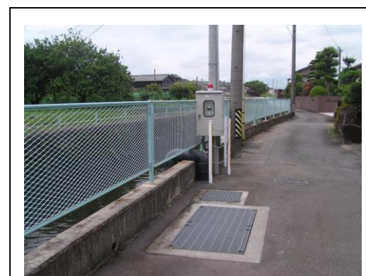
写真-4-6 排水ポンプと特殊堤
