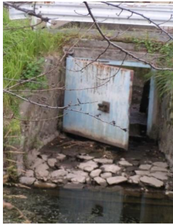
写真-2-① 高田橋排水路スイングゲート
