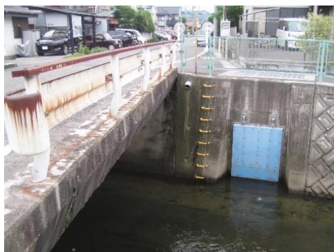
真-2-⑤ 高田東第 1号排水路フラップゲート・ポンプ
